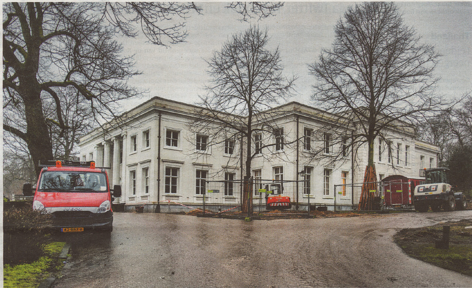
Het gemeentehuis van Bloemendaal. Bij de verbouwing blijft alleen de voorgevel heel.
